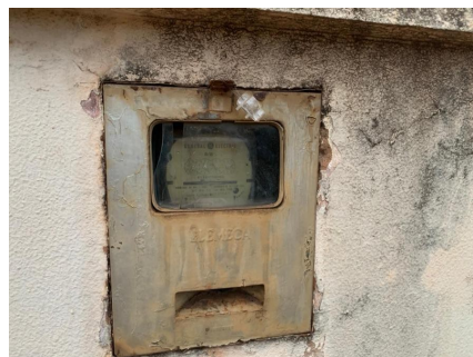
Representação Pátio Descrição Medidor de energia Data Foto 24/02/2021
