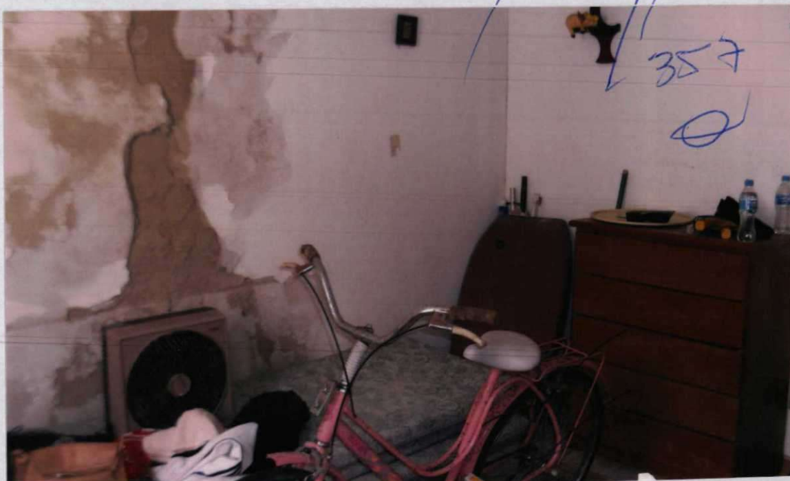
foto nº 7 - interior da sala/dormitório do apto nº 312 avaliando, observando-se o reboco e a pintura danificados, em péssimo estado de conservação.
