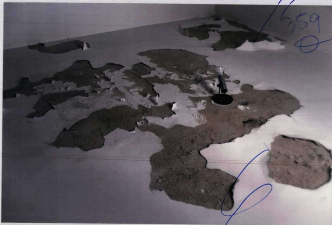
foto nº9 - detalhe do reboco da pintura do teto danificado
