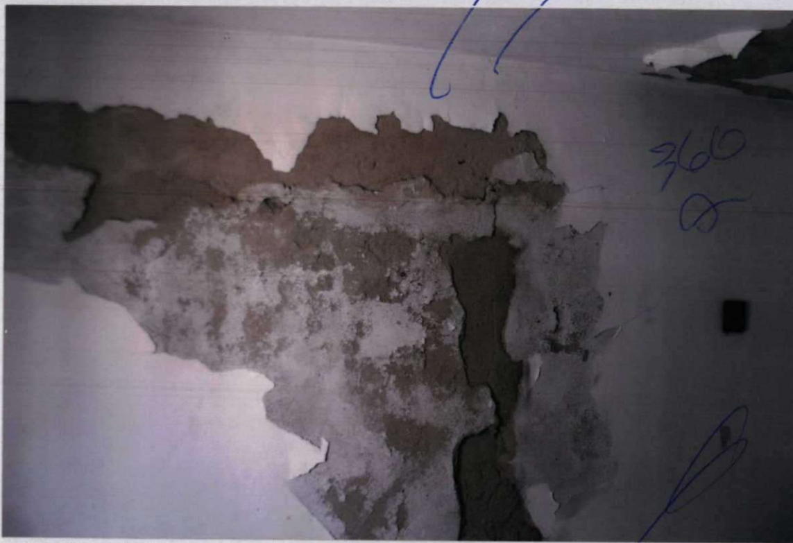
foto nº 8 - detalhe do trecho do revestimento e pintura da sala/dormitório em péssimo estado de conservação..
